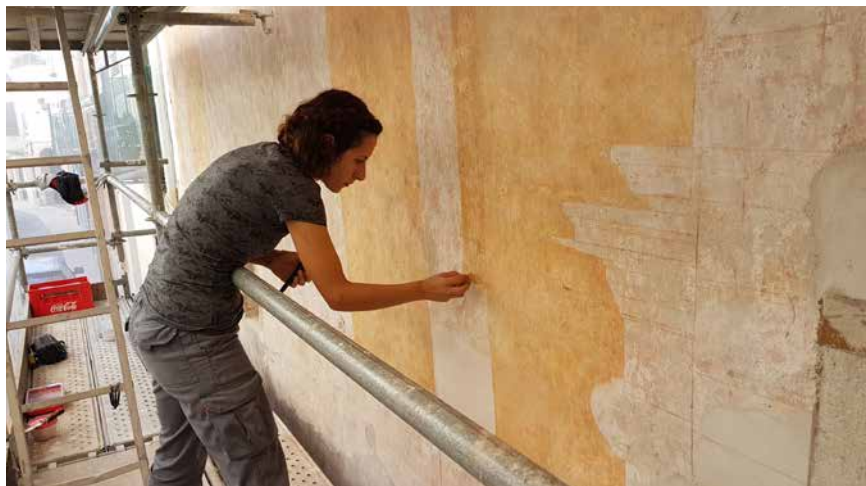
Les architectures fingides han quedat al descobert i estan en procés de restauració
