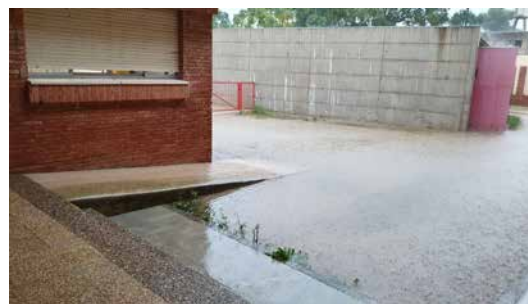
Al col·legi Assumpció l'aigua va afectar les aules de P3
