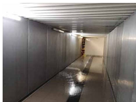
El pas subterrani de l'estació, amb aigua
