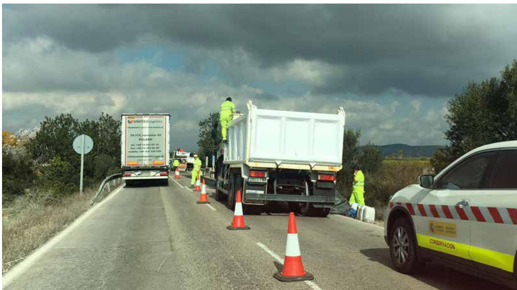
La última actuación fue un parcheo (imagen), pero la carretera continua en muy mal estado
