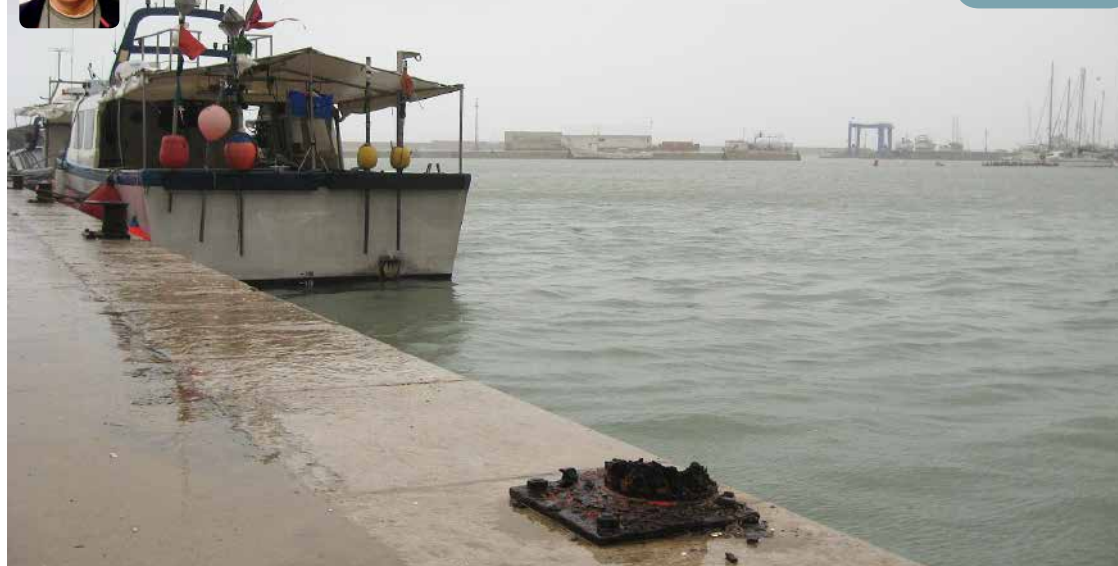
Rotura de norays en el muelle portuario por parte de pequeños barcos de la xarxa amarrados para 'resguardarse' del levant
