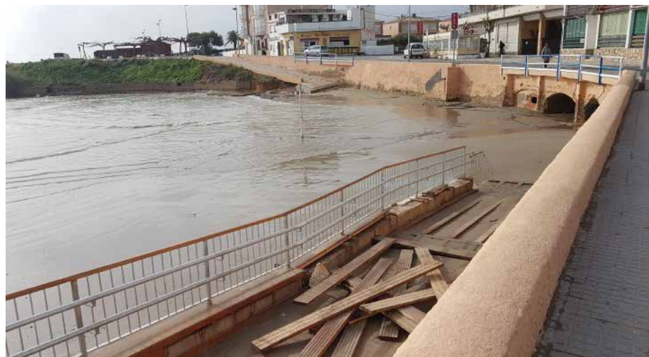
La rampa de la Platja del Clot, recentment construïda, també destrossada pel temporal
