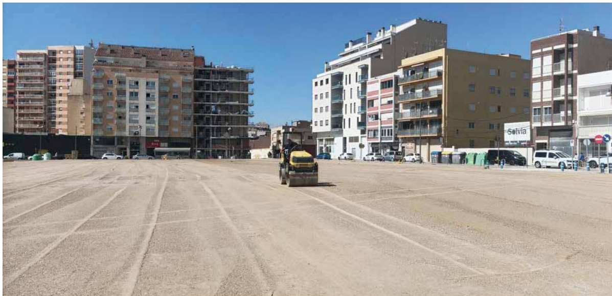
Obras de actuación en el parking de la avenida Tarragona, el pasado martes
